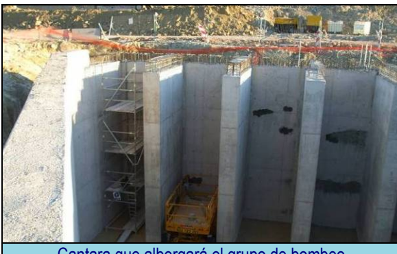
Cántara que albergará el grupo de bombeo
